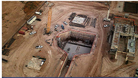
RBWWTP | EL PASO, TX
